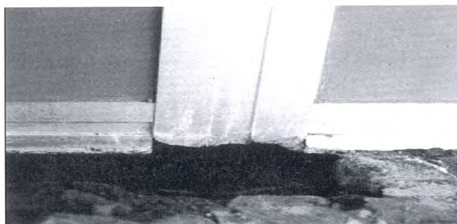
Fig. 3 – Aspetto di un serramento deteriorato a causa della presenza nel terreno di prodotti a base di cloruri (foto tratta dalla pubblicazione CIOA Difetti dell'alluminio e dell'alluminio anodizzato )
