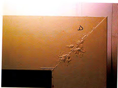
Fig. 6 – Aspetto del nodo destro del campione dopo prova di corrosione. Le superfici di taglio non erano state protette prima dell'assemblaggio dell'angolo (dall'archivio fotografico del laboratorio QUALITAL)
