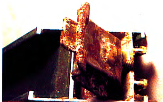
Fig. 2 – Squadretta di collegamento in ferro totalmente corrosa in esercizio (dall'archivio fotografico del laboratorio QUALITAL)
