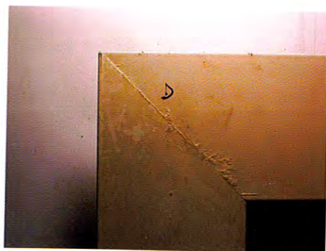
Fig. 7 – Aspetto del nodo sinistro dello stesso campione dopo prova di corrosione. Le superfici di taglio erano state protette prima dell'assemblaggio, tuttavia il non perfetto serraggio del nodo ha favorito l'inesco della corrosione (dall'archivio fotografico del laboratorio QUALITAL)
