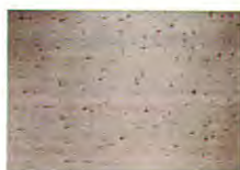
Figg. 2 e 3 – Superfici con corrosioni molto estese e aspetto della superficie dopo spazzolatura spinta (foto tratte dalla pubblicazione CIOA Difetti dell'alluminio e dell'alluminio anodizzato )
